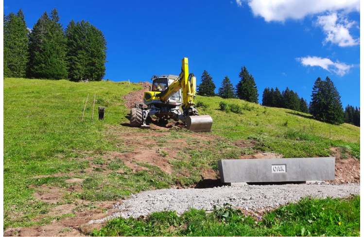
Der neue Weidetrog ist installiert und die eingelegte Wasserleitung im Alpperimeter Isentobel konnte bei herrlichem Sommerwetter zugedeckt werden.
