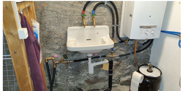
Der neue Gasdurchlauferhitzer in der Alpütte Silberer Schattgaden sorgt für Warmwasser.
